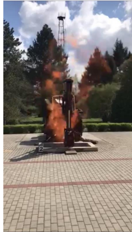
4. ábra: Munkagép által megsértett vezetékből kiömlő gáz égése
