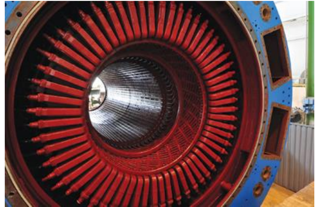
TVV221 típusú generátor állórész 250MVA, Paksi Atomerőmű
