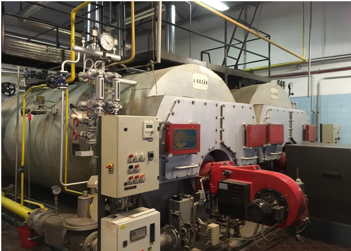
4. kép: Kazánok a fűtőházban
