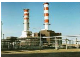
GT2 OCGT 156 MW, 1996 -
