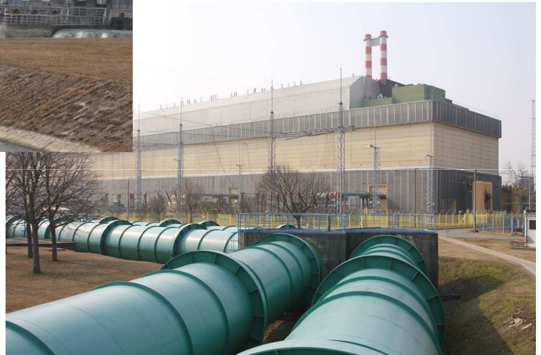
Kondenzátorhűtővíz-vezeték (Fotó: AA)
