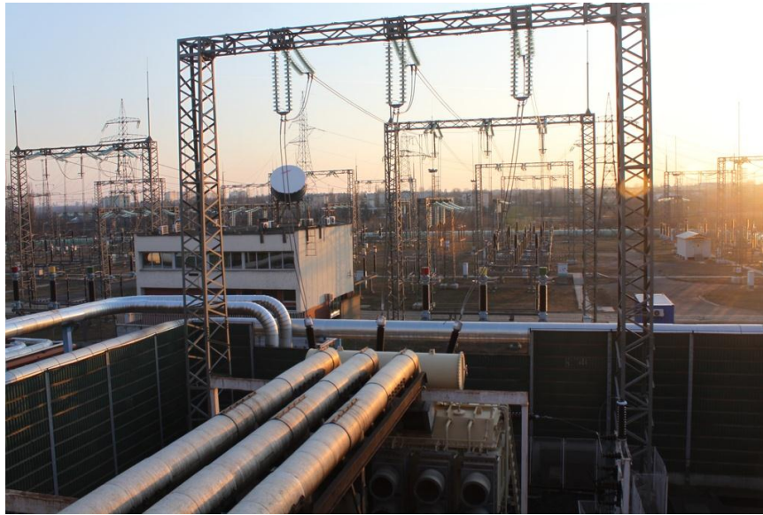
7. ábra: Az erőmű mögött elhelyezkedő 220/120 kV-os állomás
