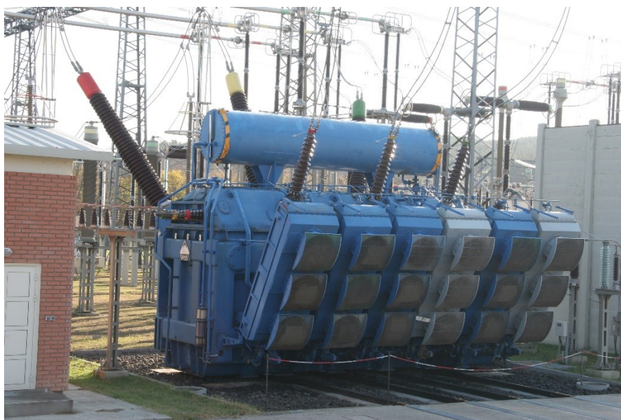
1. ábra: A 400/120 kV-os transzformátor
