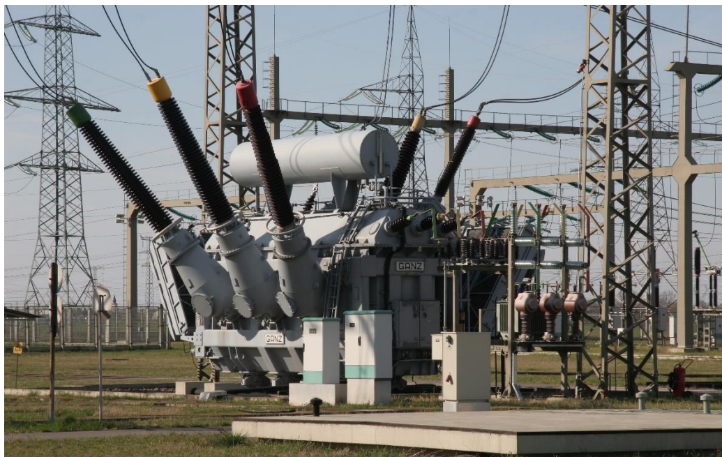
4. ábra. A 400/220 kV-os transzformátor
