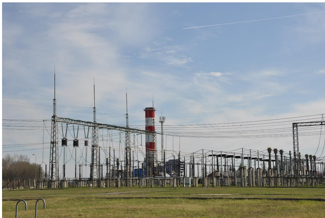
2. ábra. Az alállomás és a Gázturbinás Erőmű
