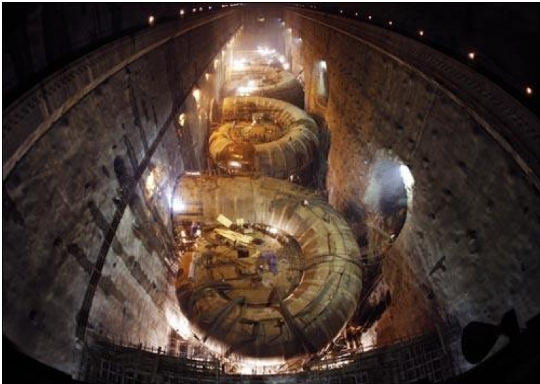
A 700 MW-os Francis-turbinák összeszerelt csigaházai
