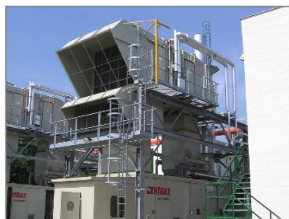
12,2 MW e TEVA gázturbinás kiserőmű Gödöllő
