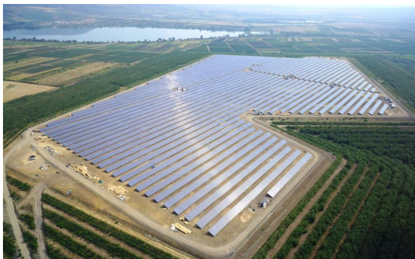
4. ábra: A 16 MW-os napelem park
