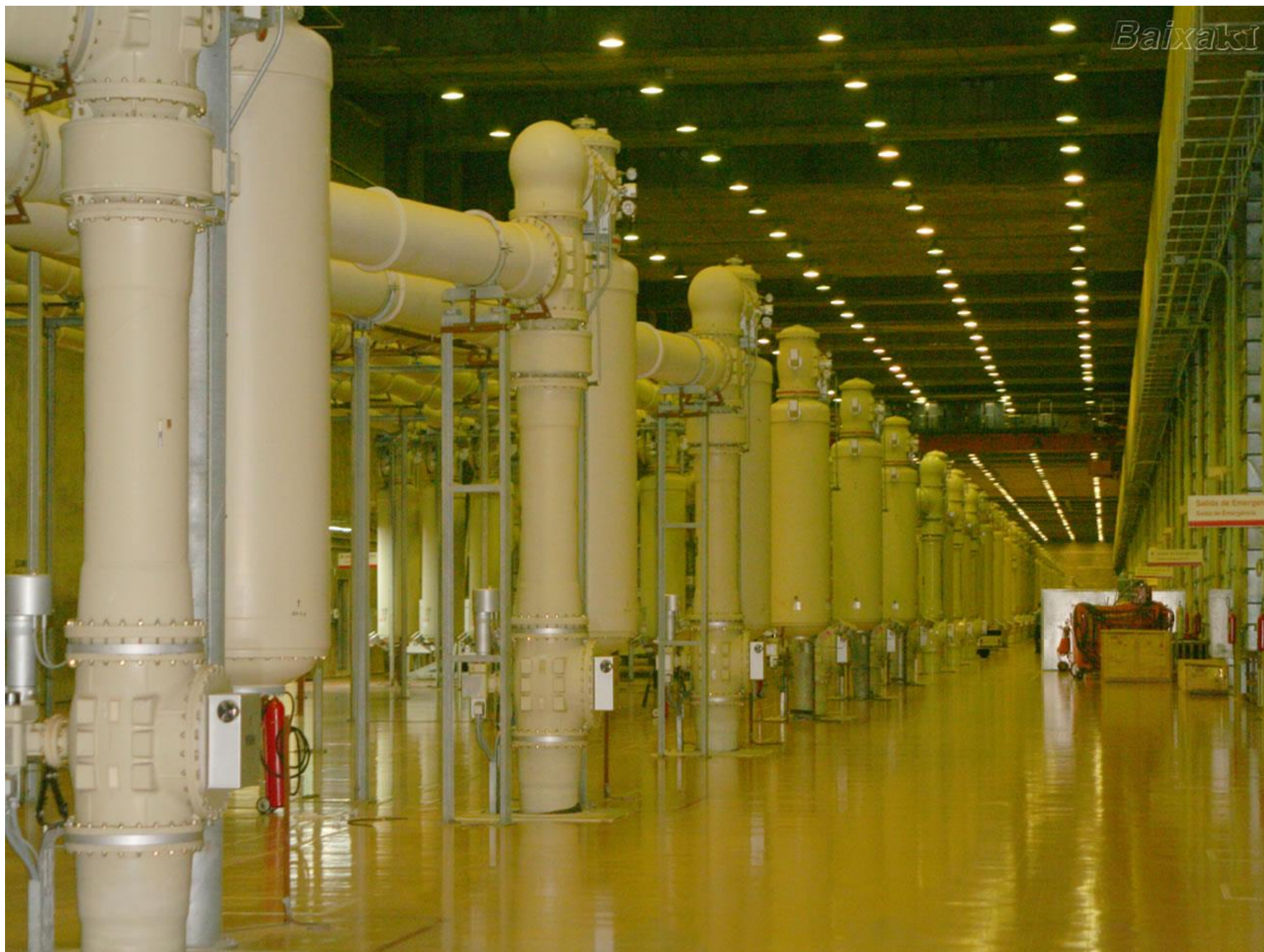
Az Itaipu erőmű 550 kV-os SF 6 szigetelésű kapcsolóberendezése.
