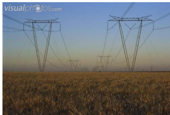
7. ábra: 750kV-os távvezeték, "nabla" tartóoszloppal
